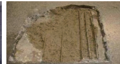
床版上面土砂化の状況
