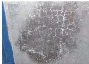
床版の遊離石灰ひび割れ・漏水
