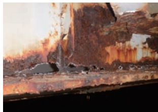
鋼橋主桁の腐食減肉・欠損
