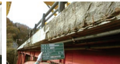
補修 10 年後の再劣化状況
