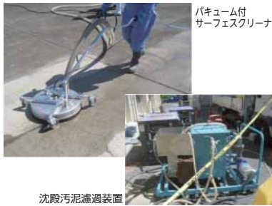
沈殿汚泥濾過装置
