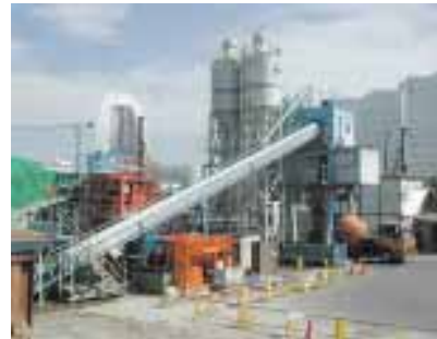
流動化処理プラント
