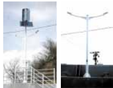
ガイドベーン付クロスフロー形風力発電装置 (写真右 KT-190 親機、写真左 子機、山田漁港津波緊急避難対策にて)
