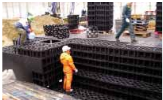
アクアトラップ設置状況 (宮城県塩竈市)
