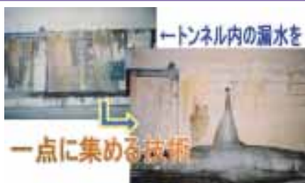
なぜ漏水するのか…、そこから攻めていきます。
