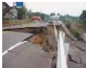
緊急輸送道路の地震被害例
